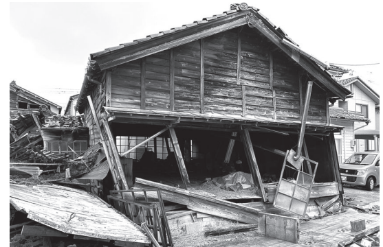
② 被災した輪島塗木地師の工房
